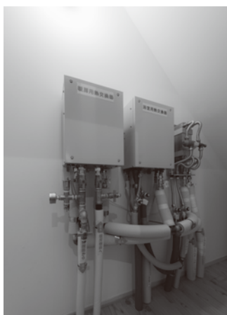
木質バイオマスエネルギー利用のための熱交換器
